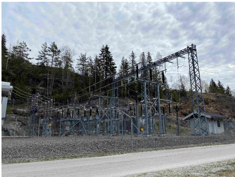
Figur 11 Eksisterende Kaggefoss transformatorstasjon langs Kaggefossveien skal utvides noe mellom eksisterende stasjonsområde og Kaggefossveien.
