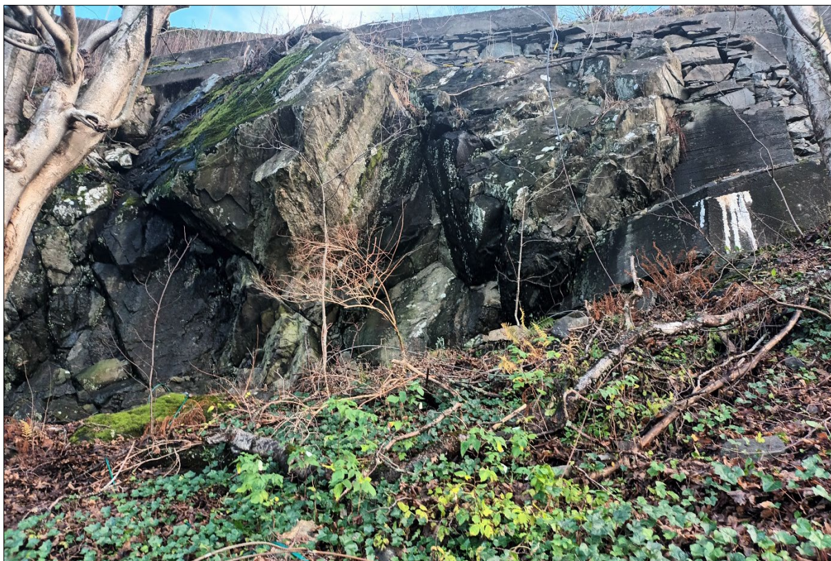
Figur 24: Sørleg del av hammarpartiet (infopunkt 3). Det er ein eldre steinmur i overkant av hammaren, sett opp i samband med utviding av vegen. Muren er òg forsterka med ein betongmur, men enkelte steinar i steinmuren har blitt trykt delvis ut, og steinmuren er antatt å vere noko ustabil.
