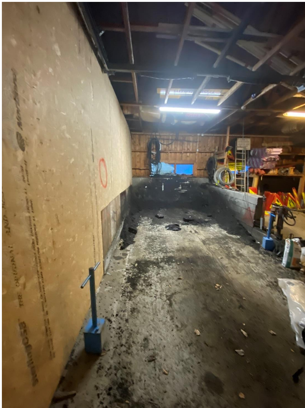
Figur 3: Tyngre rivmasser i garasjebygget med synlig asfaltforurensning.
