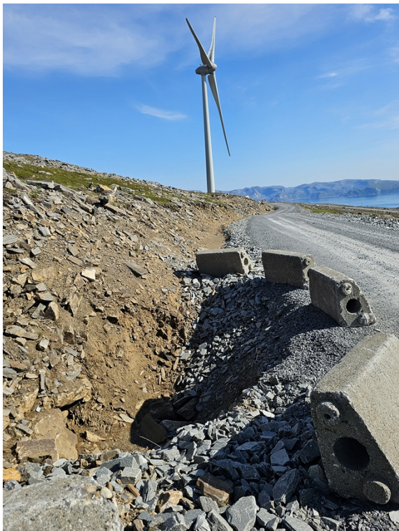
Bilde 15: Eksempel på betongklosser som er plassert langs veien og over stikkrennene. Foto: Multiconsult.
