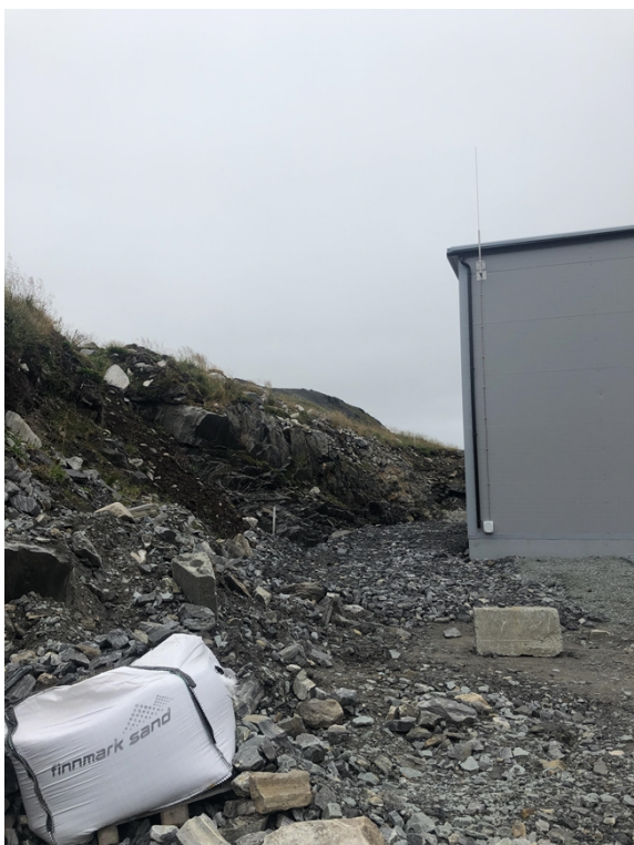
Bilde 17: Det er en god del istandsettingsarbeider igjen ved stasjonen. Her fra baksiden av transformatorbygget. Foto: NVE.
