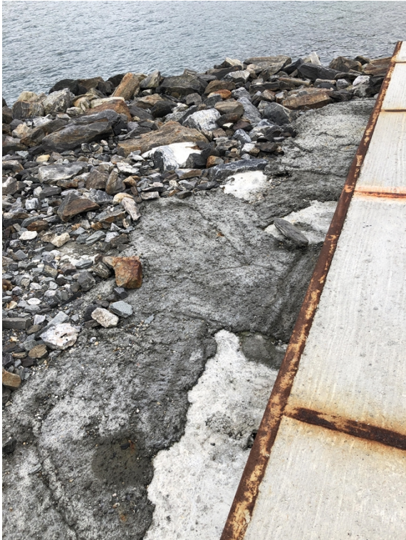
Bilde 10: Betongsøl langs betongsålen ytters på kaia. Dette må fjernes, og mer stein må tilføres for å få et godt sluttresultat. Foto: NVE.
