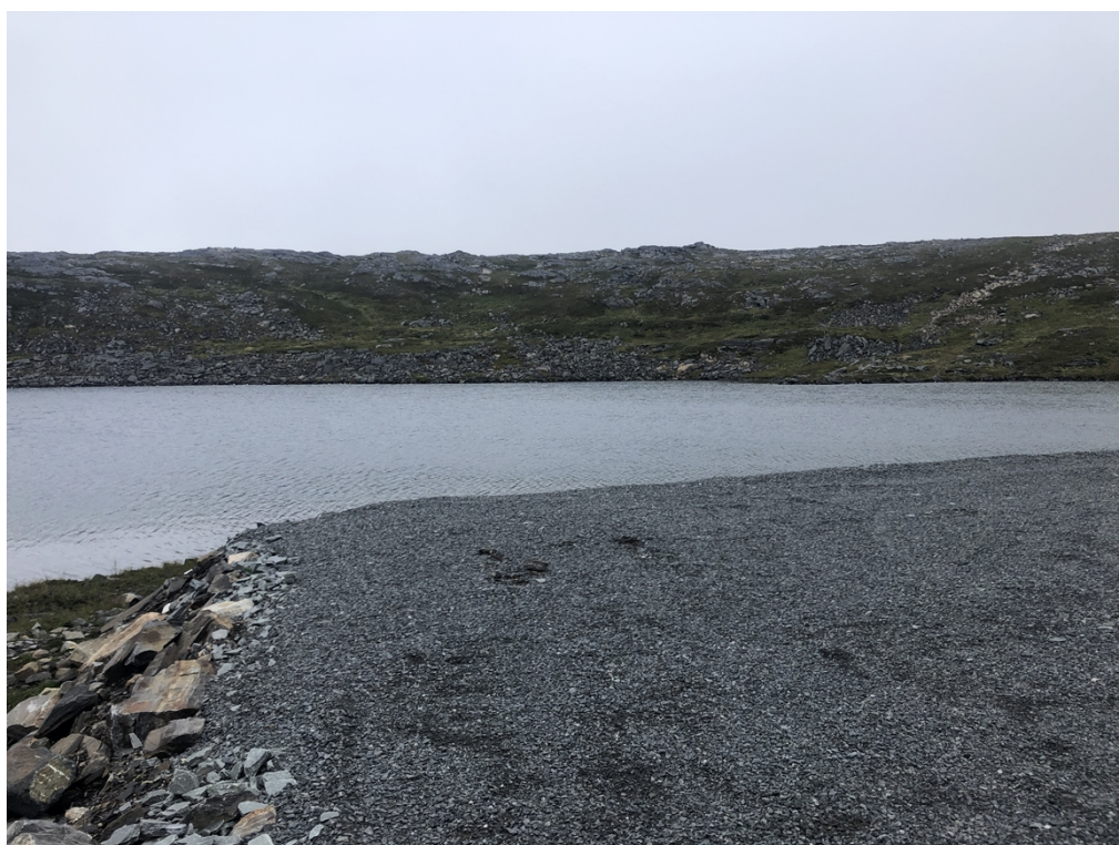
Bilde 7: Bildet viser monteringsplassen for turbin 4 med vannet i bakkant. Foto: NVE.
