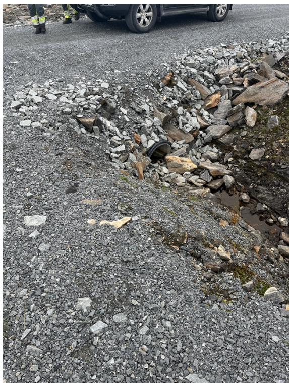
Bilde 14: Bildet viser stein i utløp av en stikkrenne. Dette må utbedres. Foto: NVE.
