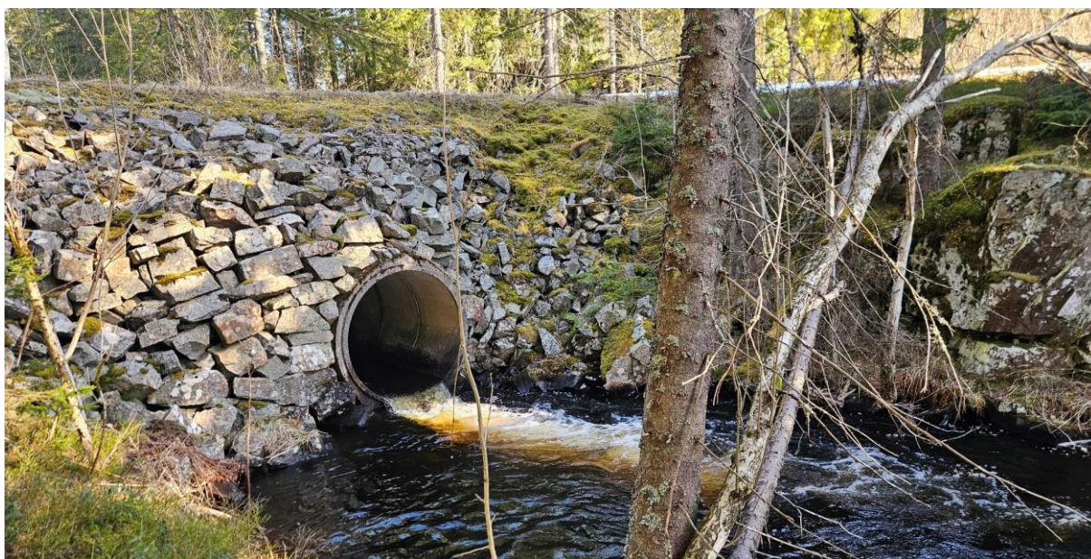
Figur 4-1. Kulvert under skogsbilvei ligger ca. 25 cm for høyt. Kulverten kan senkes eller det kan etableres en terskel i forkant for å heve vannspeilet (Sondre A. Ski / Multiconsult).
