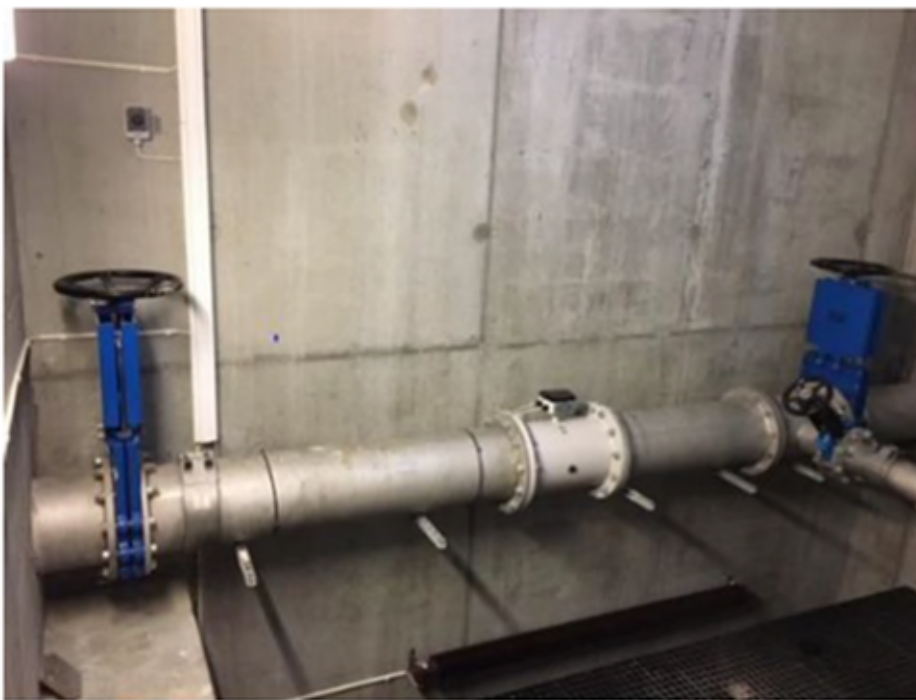
Figur 8. Eksempel på anlegg for slipp og måling av minstevannføring
