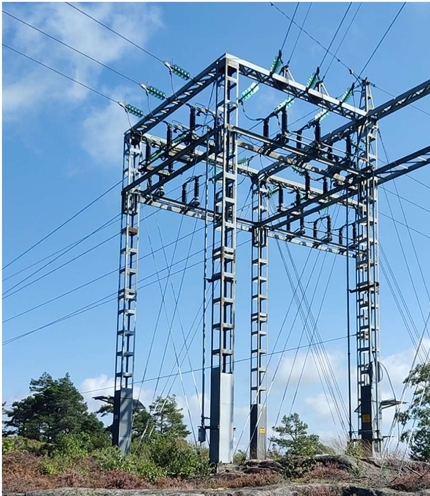
Figur 2-8: Skytterhuset koblingsstasjon sett fra sør.
