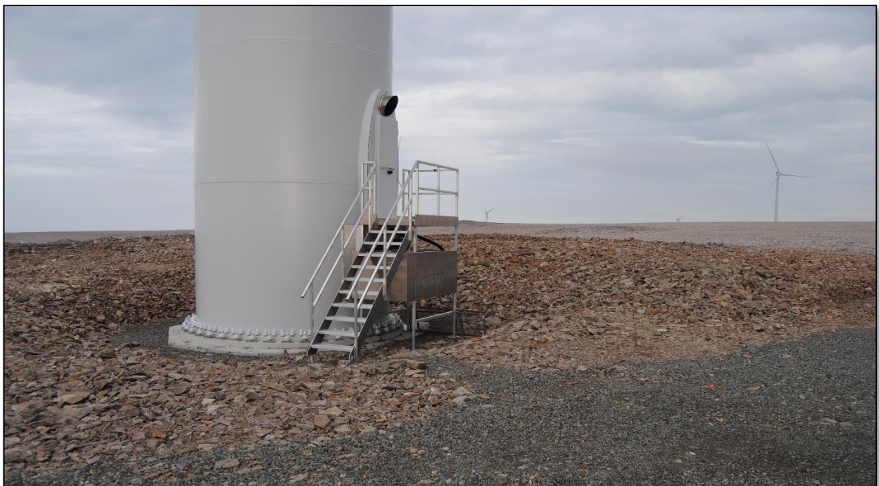
Figur 6-2. Støping av turbinfundament i Raggovidda vindkraftverk (over) og fundament/tårn etter tilbakefylling av masse (under). Mest sannsynlig vil det bli valgt samme type fundamentering på Davvi. Foto: Multiconsult Norge AS.
