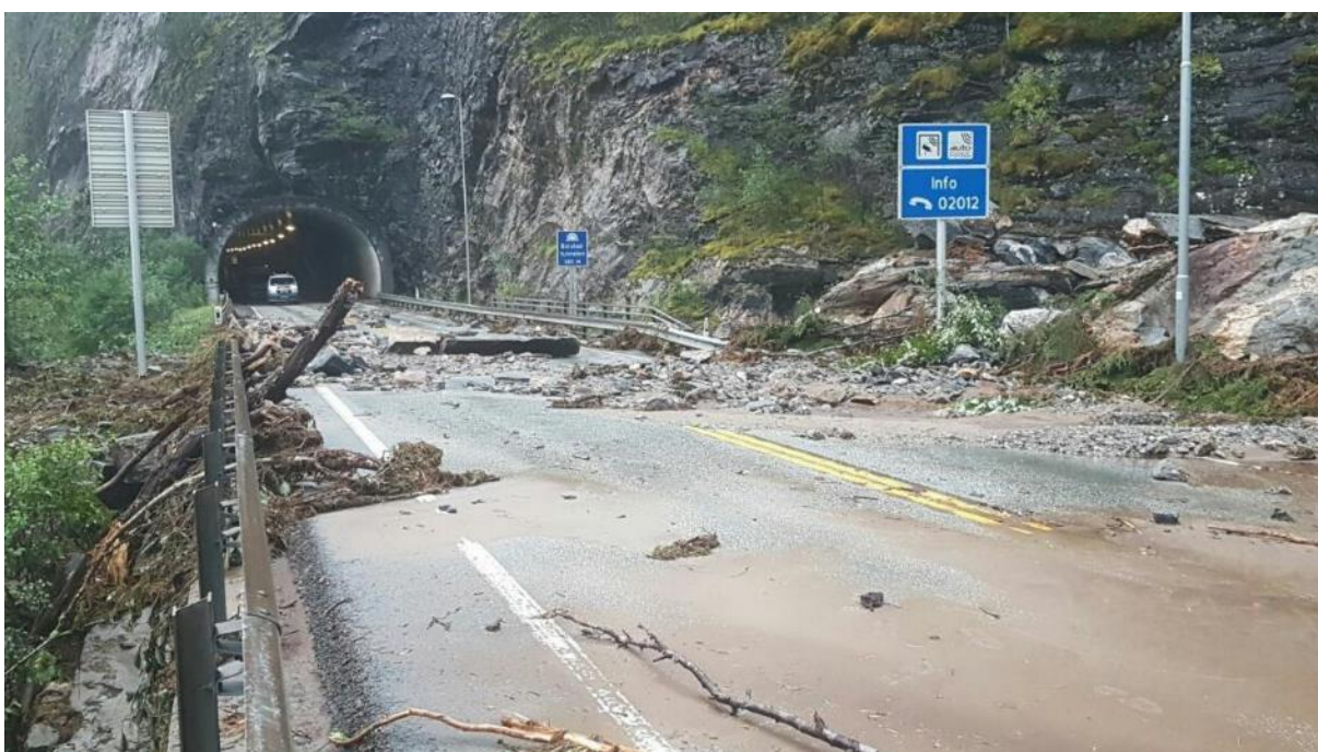
Figur 36 - Flomskred 28 august 2019. Bru/rekkverk over Geitelvi sees midt i bildet. (Kilde: www.vg.no ). Traktorvei går opp helt til høyre i bildet.
