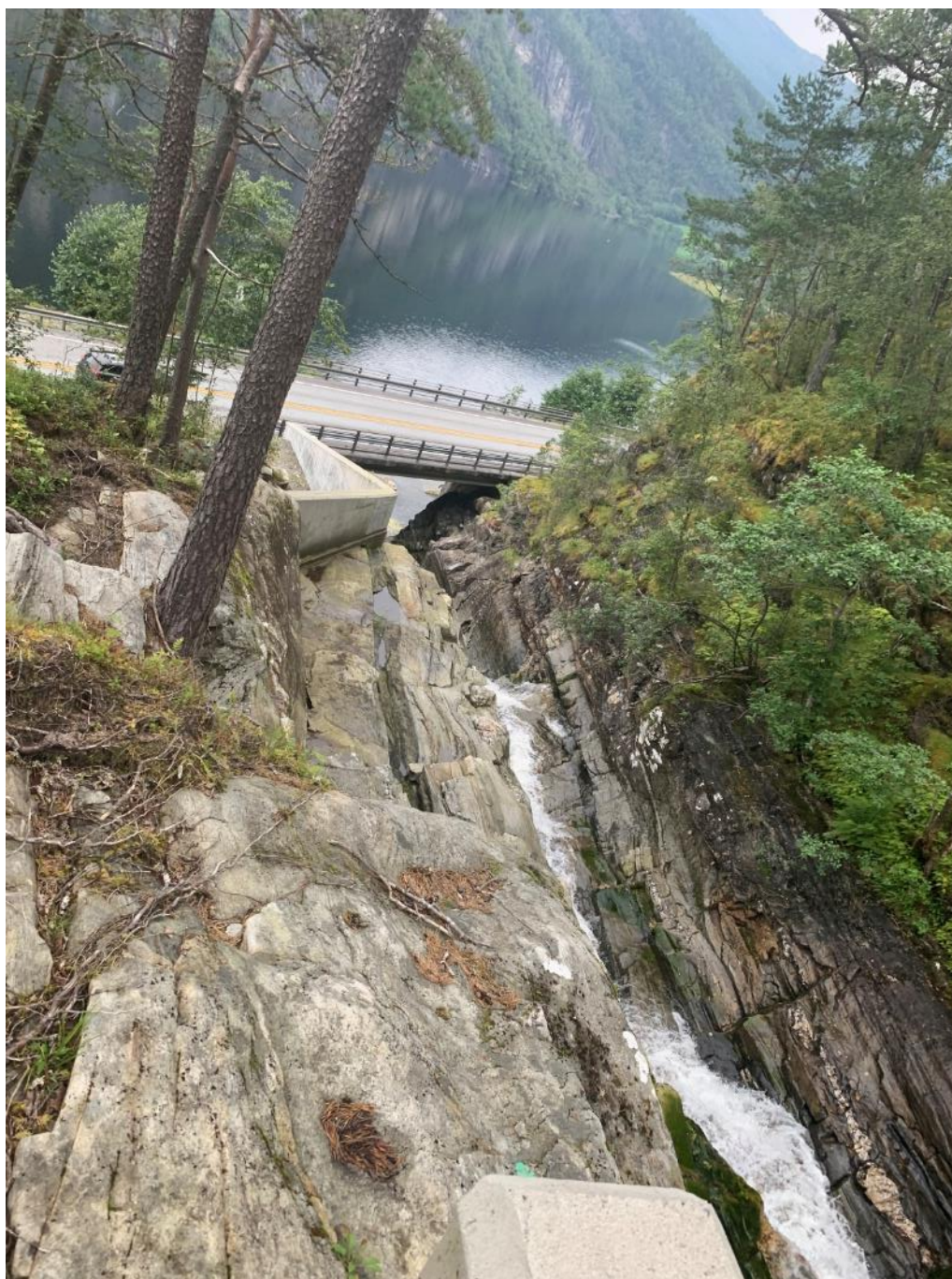
Figur 37 - Flommur/ledemur inn mot bro samt enden an flomvern ved kraftstasjon nederst i bildet. (Foto: Njord)
