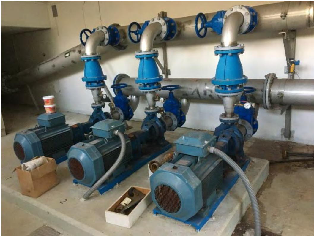
Figur 6-22. Dagens 3 pumper ved Ommundsvatnet pumpeanlegg har en samlet kapasitet på 100 l/s.
