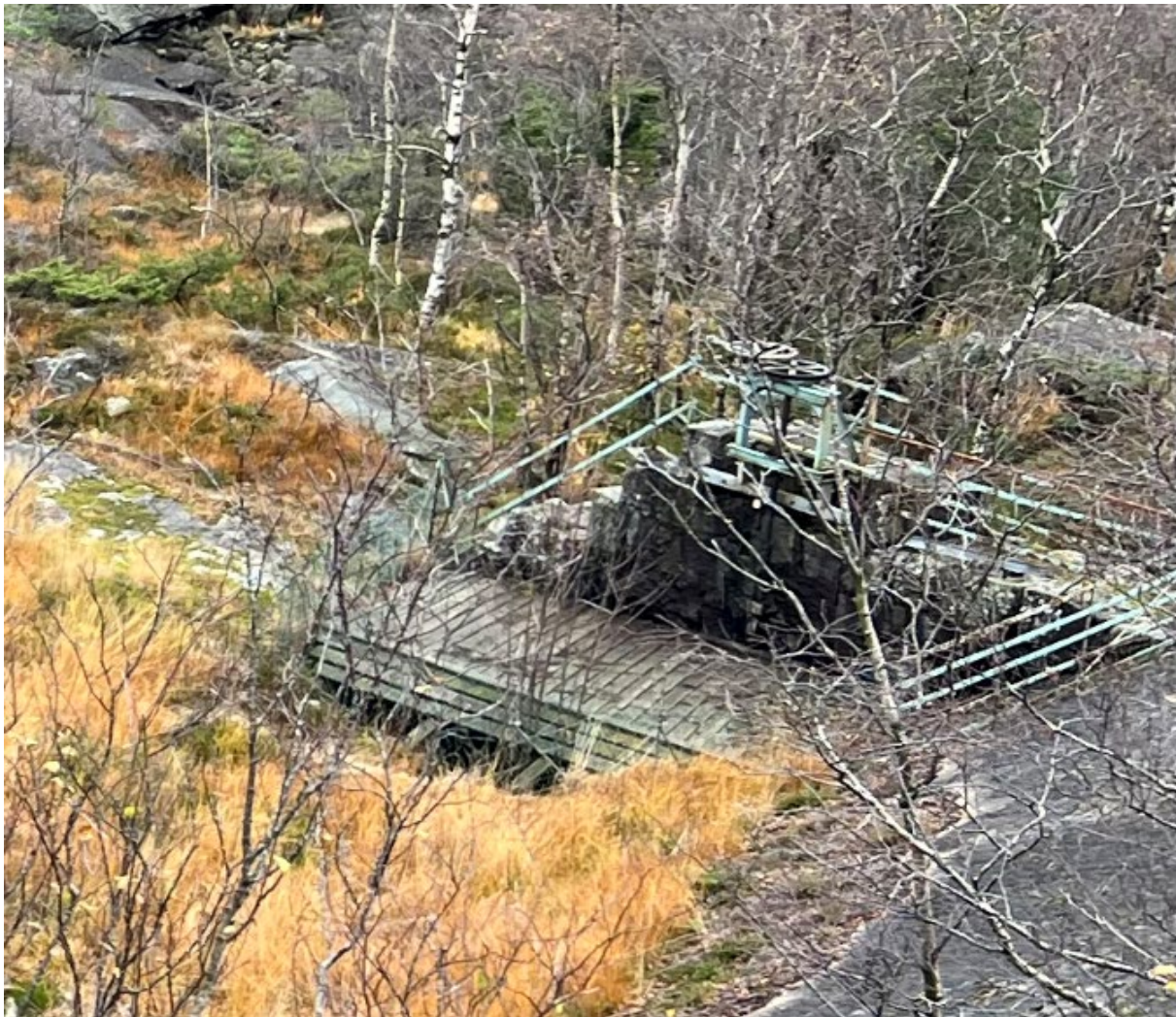
Figur 2-9 Bilde viser innretningen for dagens manuelle lukkemanøvrering.
