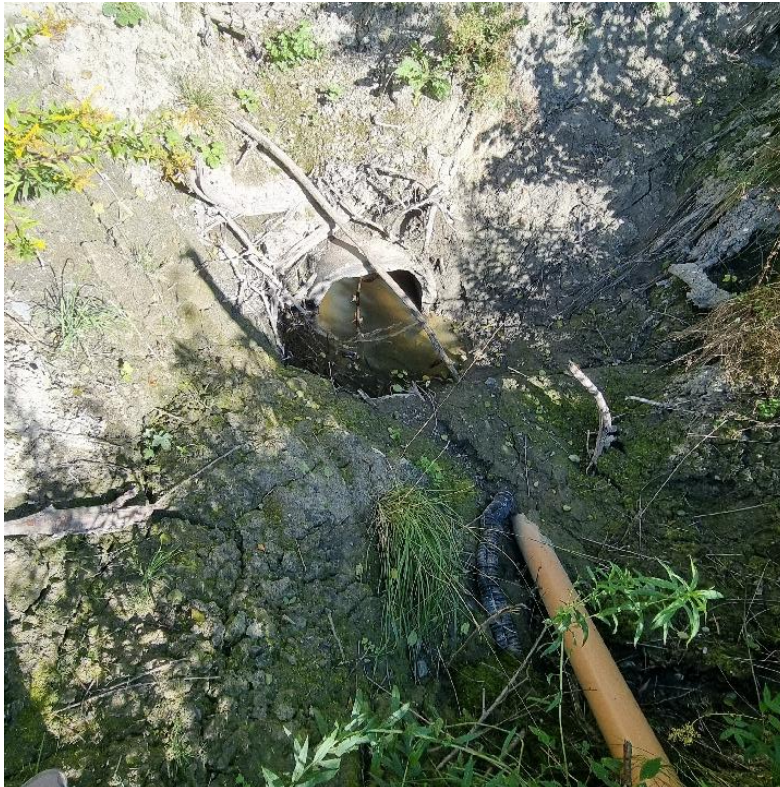
Figur 8-1 Skadet innløp til kulvert nederst i den øvre delstrekningen. Bilde fra befarig 19.08.2025.
