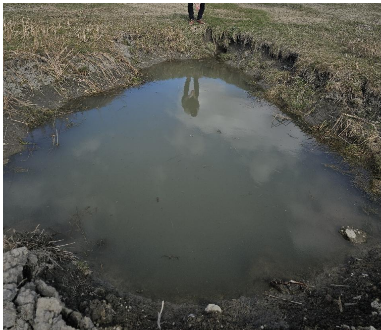
Figur 8-2 Synkehull over kulvertkrysning mellom øvre og midtre delstrekning langs Vangsbekken, antagelig forårsaket av erosjon langs den skadede kulverten under jorden. Bilde fra befarig 13.05.2025.
