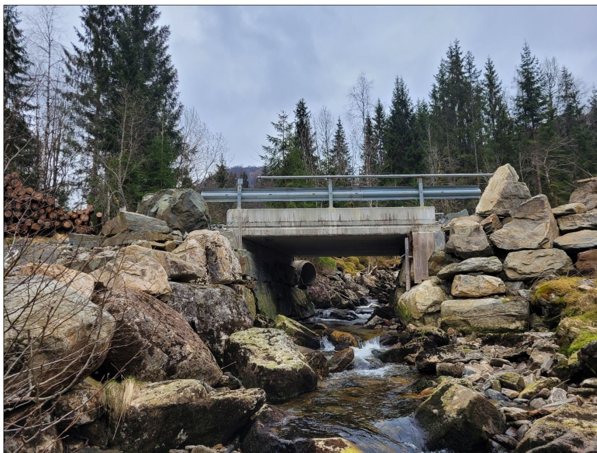
Figur 25: Broåpning er vurdert som et kritisk punkt langs elveløpet og ved oppdemming kan potensielle skred bryte elveløpet og flyte utover området mot nord. Infopunkt 4
