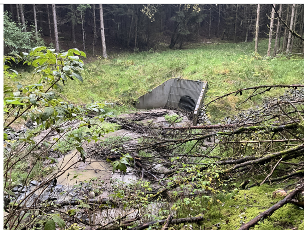
Bilde 10. Innløpet til kulverten under E6 er delvis blokkert av sedimenter og vegetasjon. Meldt inn til SVV.
