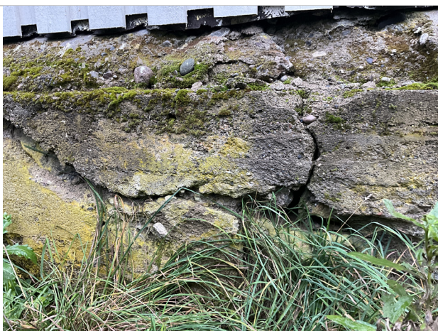
Bilde 13. Eldre sprekker i grunnmuren (Fjellboveien 19)
