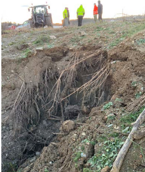
Figur 11 Status på nedsiden av vegen
