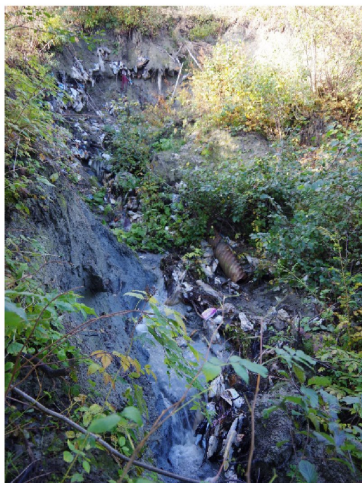
Figur 8. Oversikt av skredgropa
