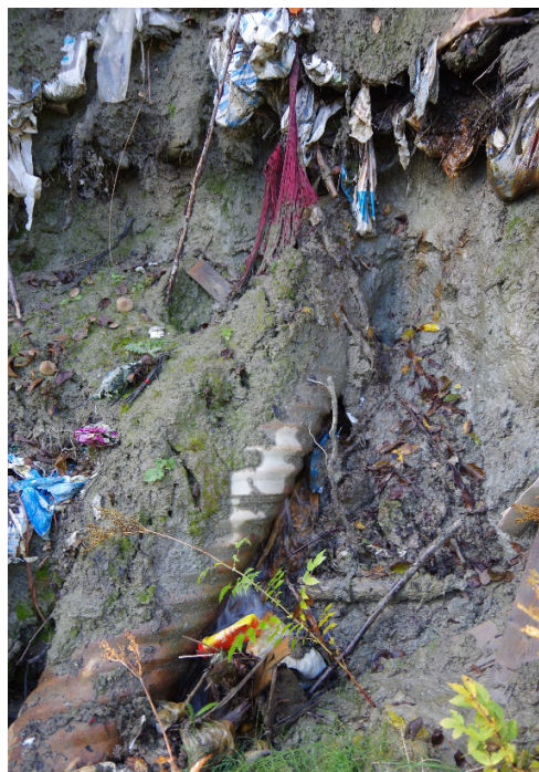
Figur 7. Ødelagt rør gjennom søppefylling
