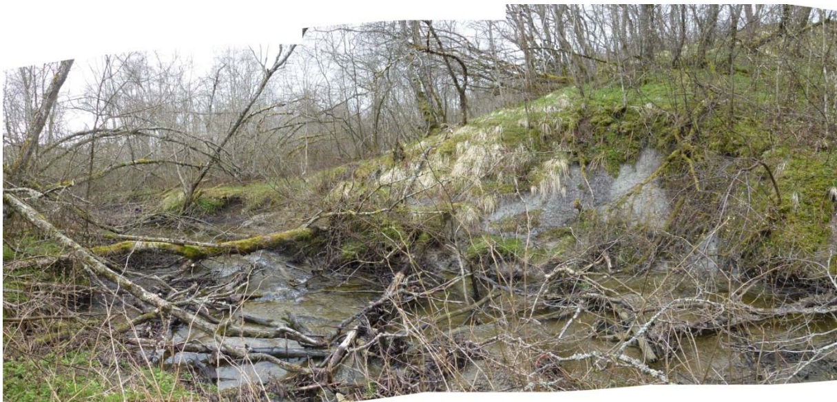
Bilde 667-669 Kvisetbekken, erosjon venstre side bekk
