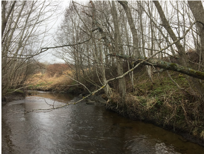
Figur 4: Det er spor etter erosjon og flere mindre utglidninger i Prestelva på strekningen mellom Askjemdalen og Teglverksveien. Elva bærer preg av kraftig bunnsenking, flere mindre slepp og en del sig i skråningene.
