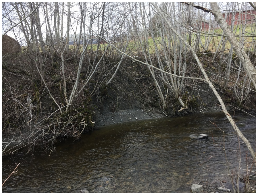
Figur 5: Erosjon og sig langs Prestelva
