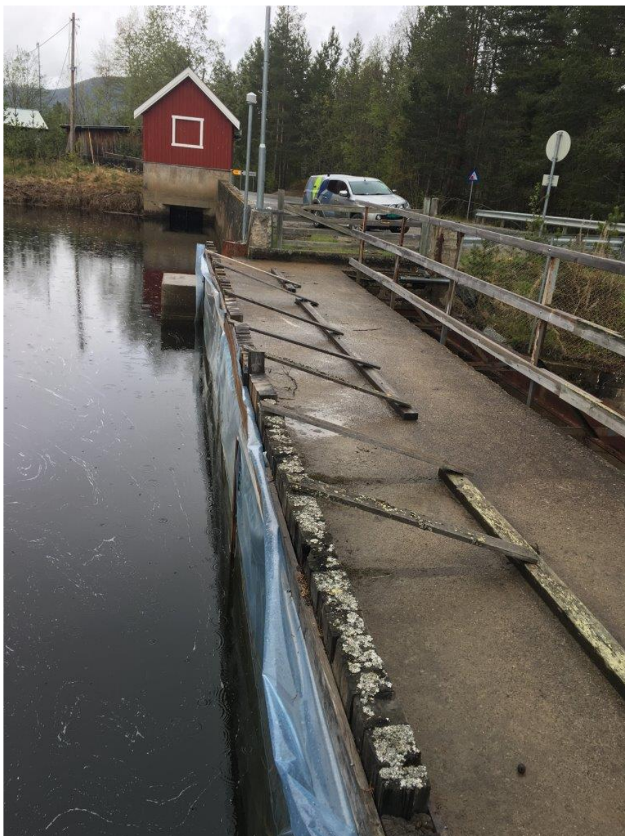
Figur 19. Sølnadammen sett mot nordre landfeste, med nåleløpsseksjonen sentralt i bildet. Det er lagt plast foran nålene i et forsøk på å redusere lekkasjer og holde vannstanden oppe i inntaksbassenget. Det røde huset i bakgrunnen er lukehuset med mekanisme for åpning og stenging av vann til tilløpsrøret til gamle Sølna kraftverk.
