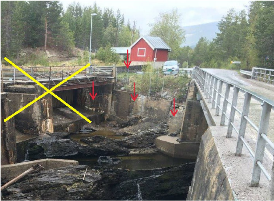
Figur 28. Røde piler angir deler av dammen som planlegges bevart. Gult kryss angir konstruksjoner i bildet som planlegges fjernet. Ved å spare nordre del av dammen, markert med røde piler, kan også parkeringslommen der bilen står opprettholdes.
