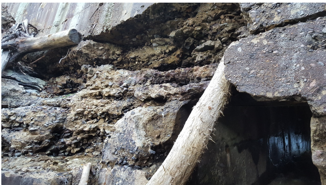
Figur 18. Nærbilde betongskade i damfoten ved utløp av tappeløpet fra bunnluken.
