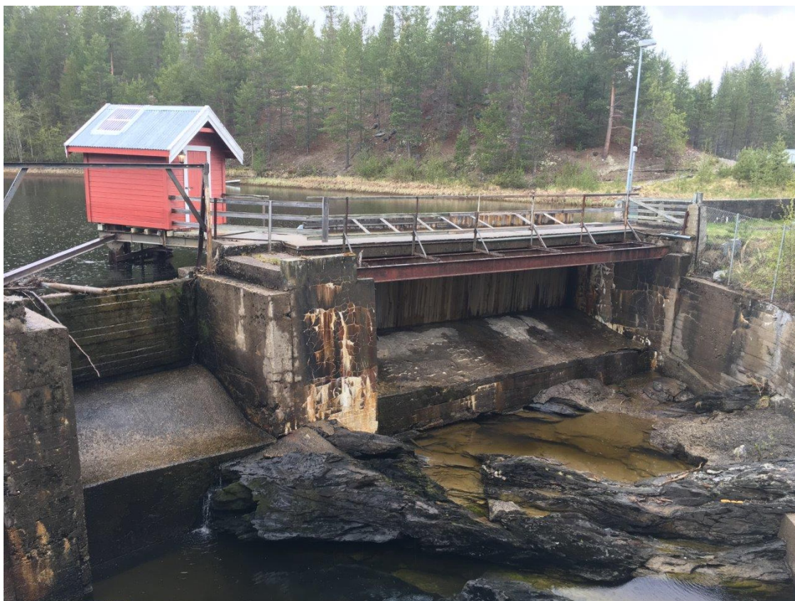
Figur 15. Sølndammen med tappeløp til venstre og nåleløpsseksjon til høyre. Lukehuset midt i bildet huser innretning for regulering av luke i tappetunnelen.
