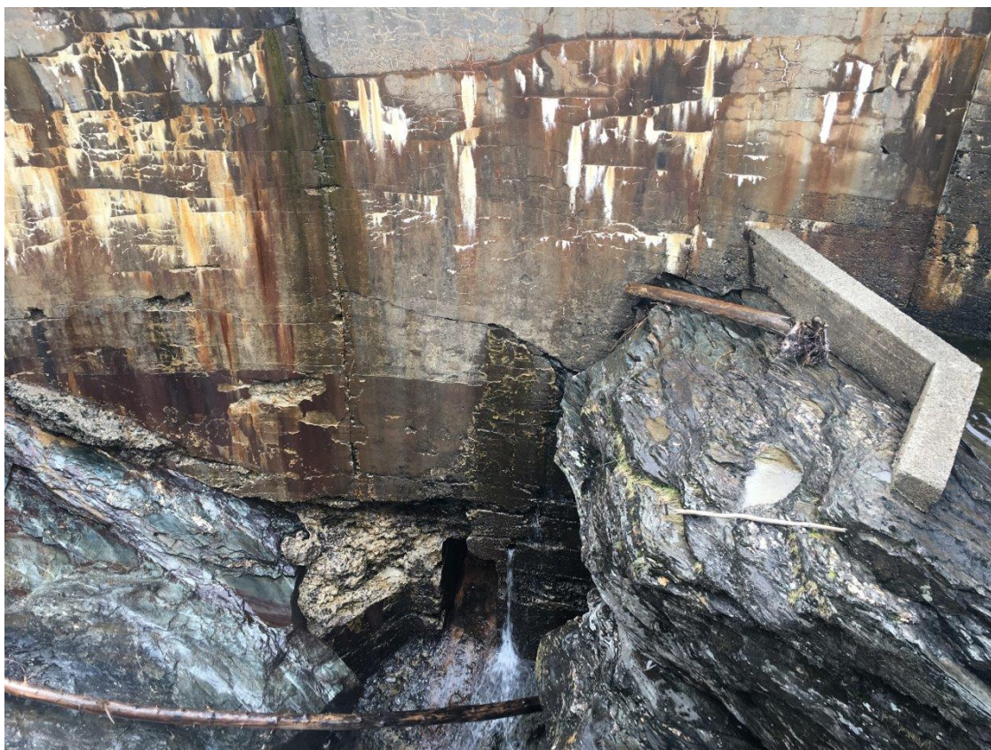
Figur 16. Sølndammen luftside under overløpet har dype sprekker som svekker konstruksjonen, og det er lekkasjer gjennom dammen. Tappeløp fra bunnlukes sees i bunn av dammen.
