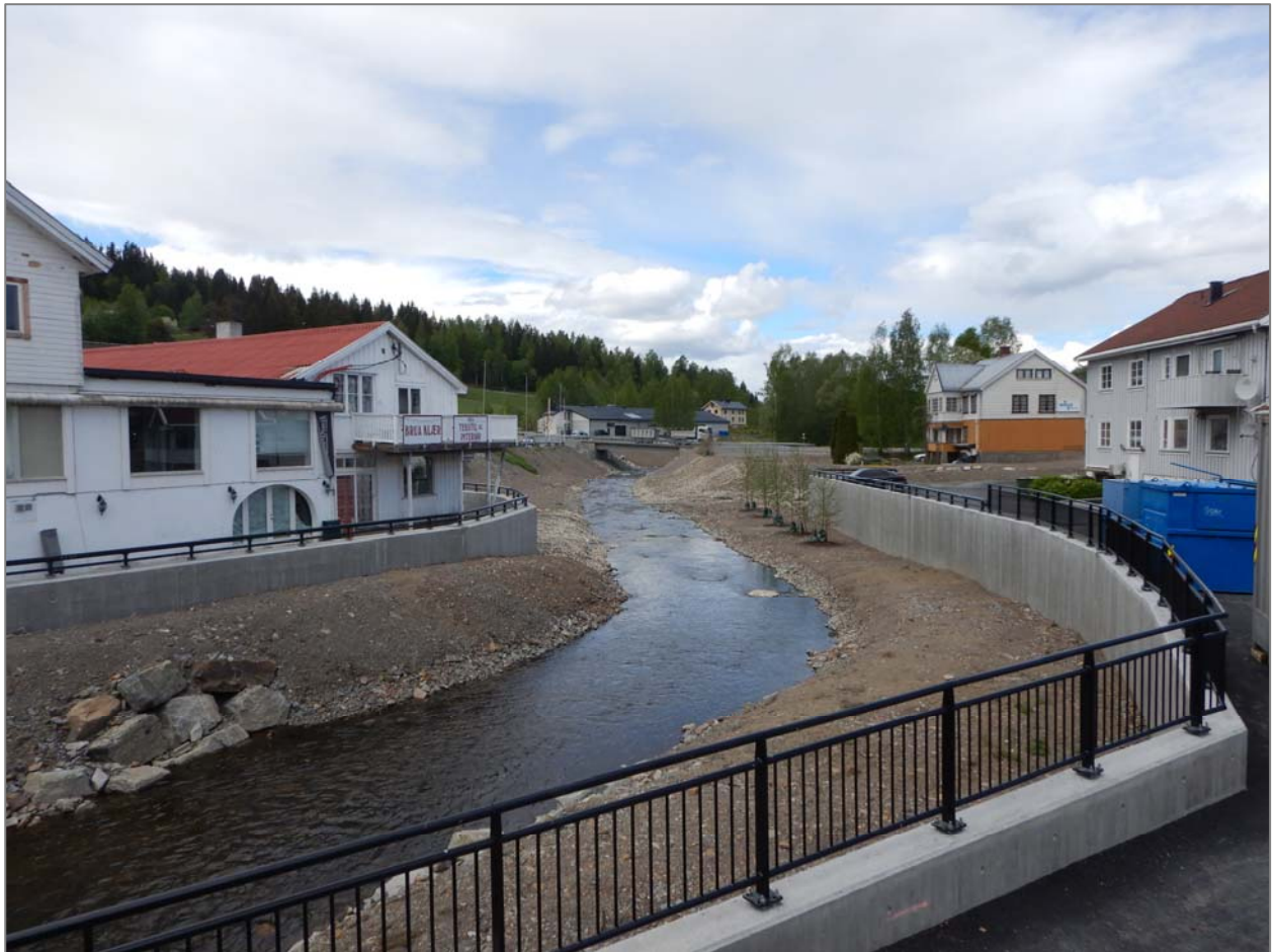
Figur 3.11 Flomsikringsmurer mellom samløpet med Eggeelva og Augedalsbrua og terskel i Viggas bunn nedstrøms Augedalsbrua. Foto: H. Øverland
