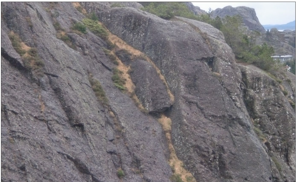
Figur 25: Bilete av blokk vurdert som ustabil ved infopunkt 6
