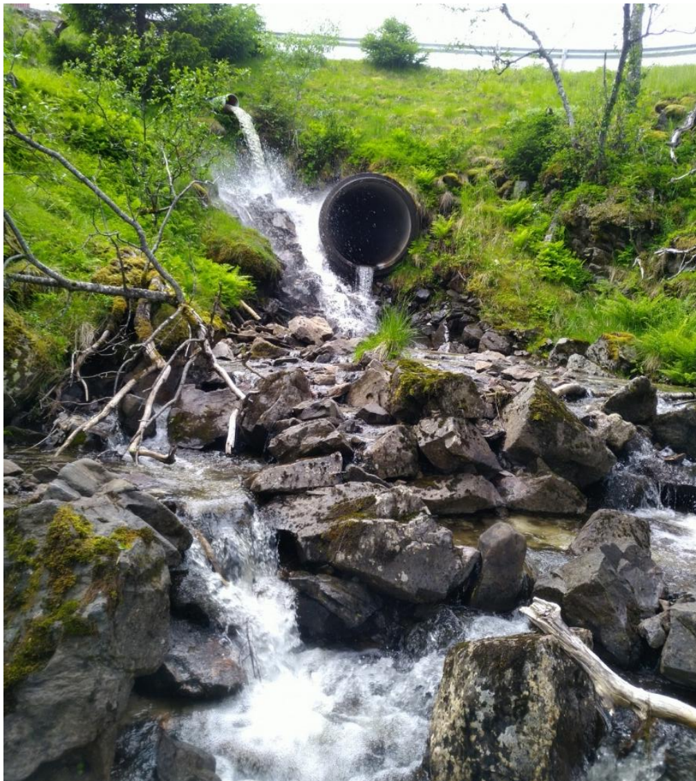
Utslipp av rejeftvann fra vannbehandlingsanlegg i røret til venstre mens el-fisket pågikk. Vannføringen ble da anslagsvis fordoblet. Det lå en del kalksand i elva her. Røret til høyre under veien inn til anlegget er oppgangshindrende for anadrom laksefisk og ål.
