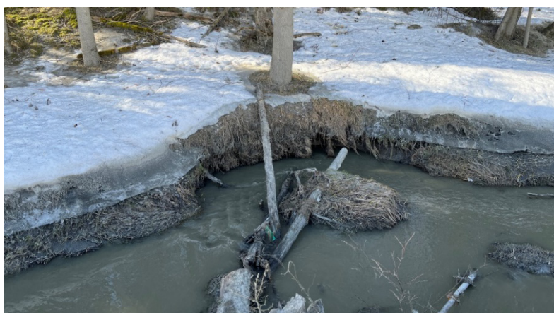
Figur 4-4 Observasjon ved befaring 2024-04-03: Hindringer i bekkeløpet leder bekkevannet inn mot skråningsfot. Erosjonen vist på bildet er ca. 1.5 meter sideveis og 0.5 meter dyp under det frosne vegetasjonsdekket. Erosjonspotensialet er stort, selv om det er lavt fall på bekken (<1%).
