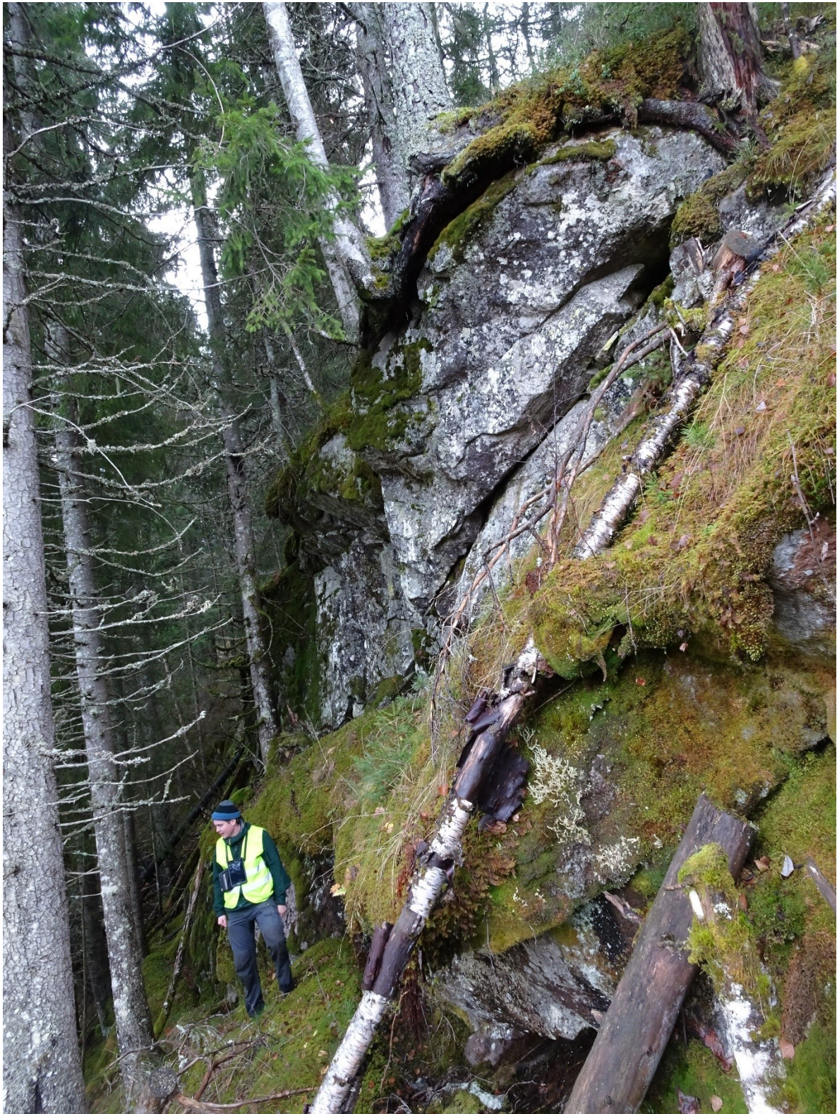
Figur 12. Løse blokker oppfor Rv9 sør for Reiårsfossen. Bildet er tatt mot sør.
