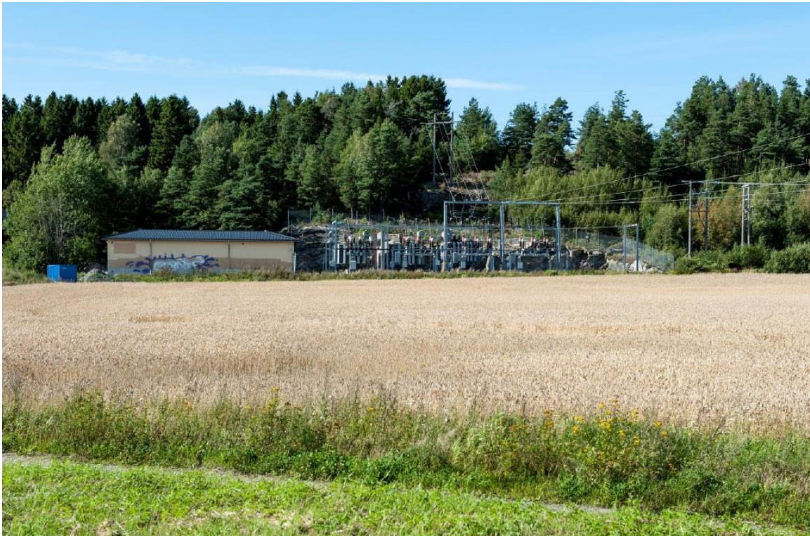
Figur 5-8. Dagens transformatorstasjon ved Fjærå, nord for Elingårdkilen.
