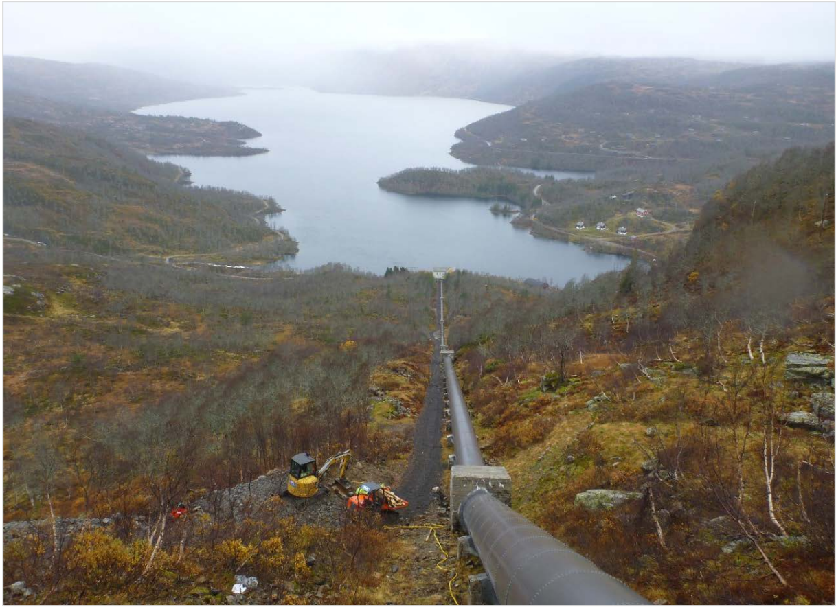
Figur 70 Rørgate ned til Hodnaberg kraftverk. Utsikt over Hamlagrøvatnet.
