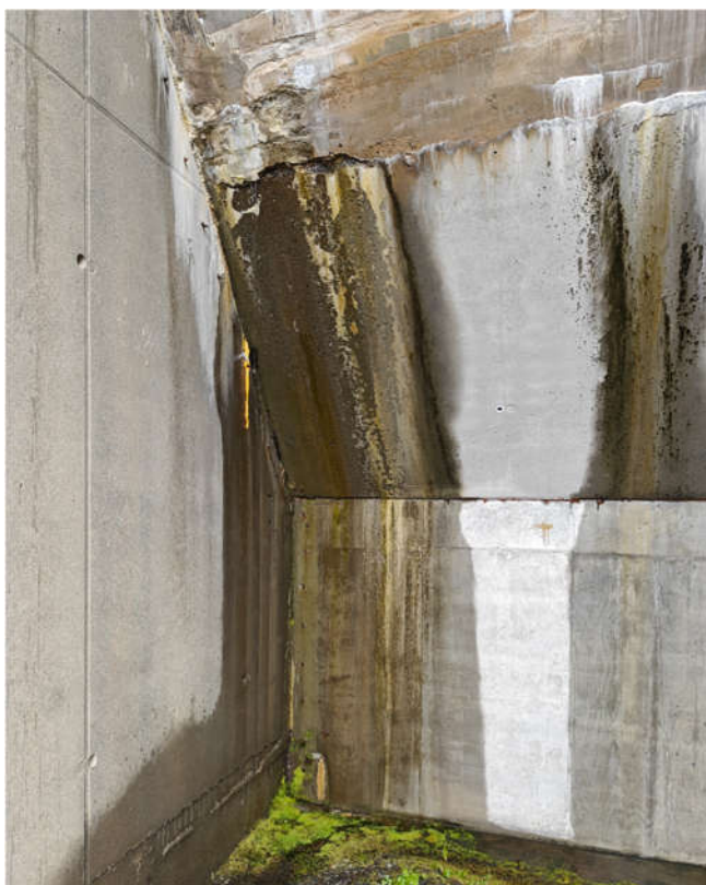
3 Lekkasje i støypeskøyt
