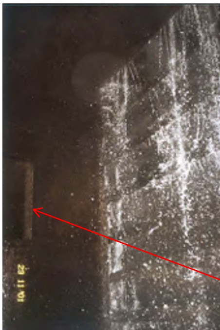
Høyre luke - store lekkasjer
