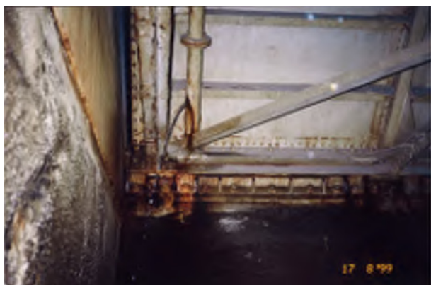
Lekkasje fra rørsystem
