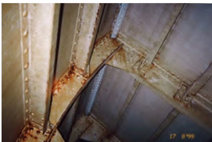
Typisk tilstand i øvre del av luka
