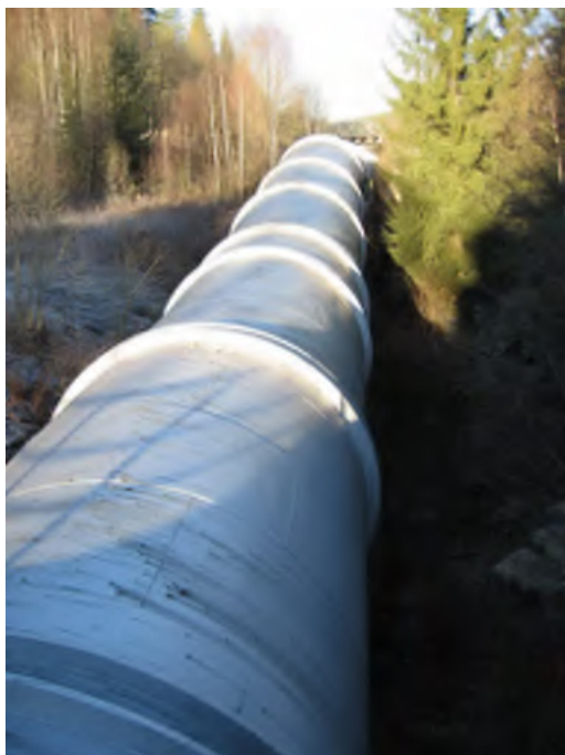
Bildet viser den generelle tilstand på overflatebehandlingen
