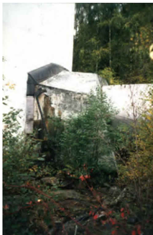
Innløp fra stålrøret i tårnet. Generelt mye riss/sprekker med mye kalkutslag
