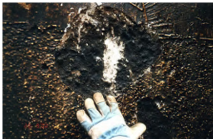
Lokal skade innvendig
