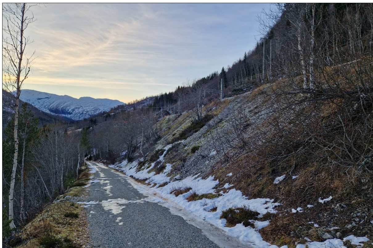
Figur 9: Bildet viser eksponerte løsmasser i nedre del av påvirkningsområdet. Her er det et tykt løsmassedecke av fyllmasser i forbindelse med utbedring av jernbanelinjen, infopunkt 2. Utfyllingen kan ikke sees på flyfoto fra 1958, men vises i flyfotoet fra 1963 (Figur 7).
