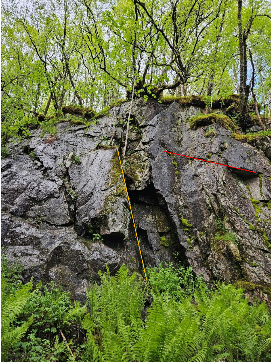
Figur 5: Skrenter fremstår svært oppsprukket. Et tilnærmet vertikalt foliasjonsplan observeres (merket oransje) med fall mot øst, samt et mer horisontalt foliasjonsplan med fall mot vest. Bildet er tatt av skrent vest i påvirkningsområdet, ca. på 65 moh.
