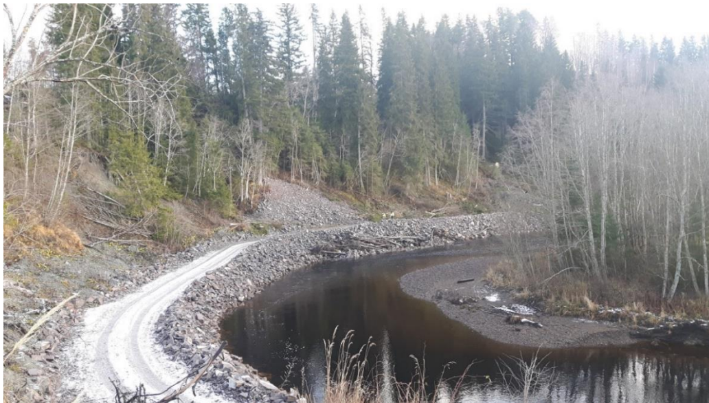
Figur 1: Avsluttet krisetiltak, i påvente av mer permanent sikring med hastetiltaket, 13.11.2017. (Foto: Roar Gartland)
