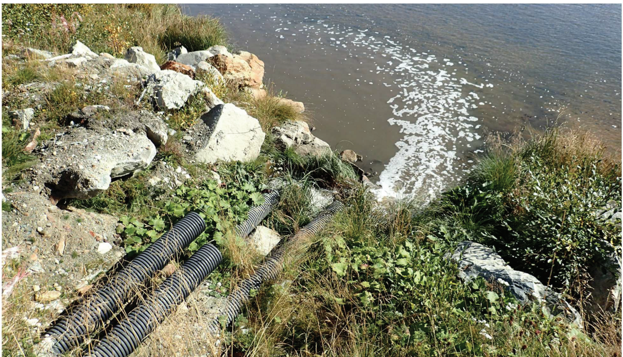
Figur 6-6 Ledninger ved utslippspunkt
