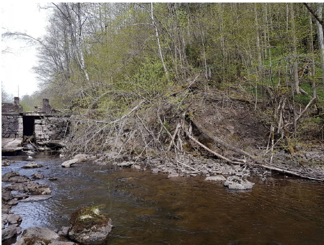
Figur 10: Tynt løsmassedekke ved dammen. Noe utglidning kan skje langs de bratte skråningene langs dammen.
