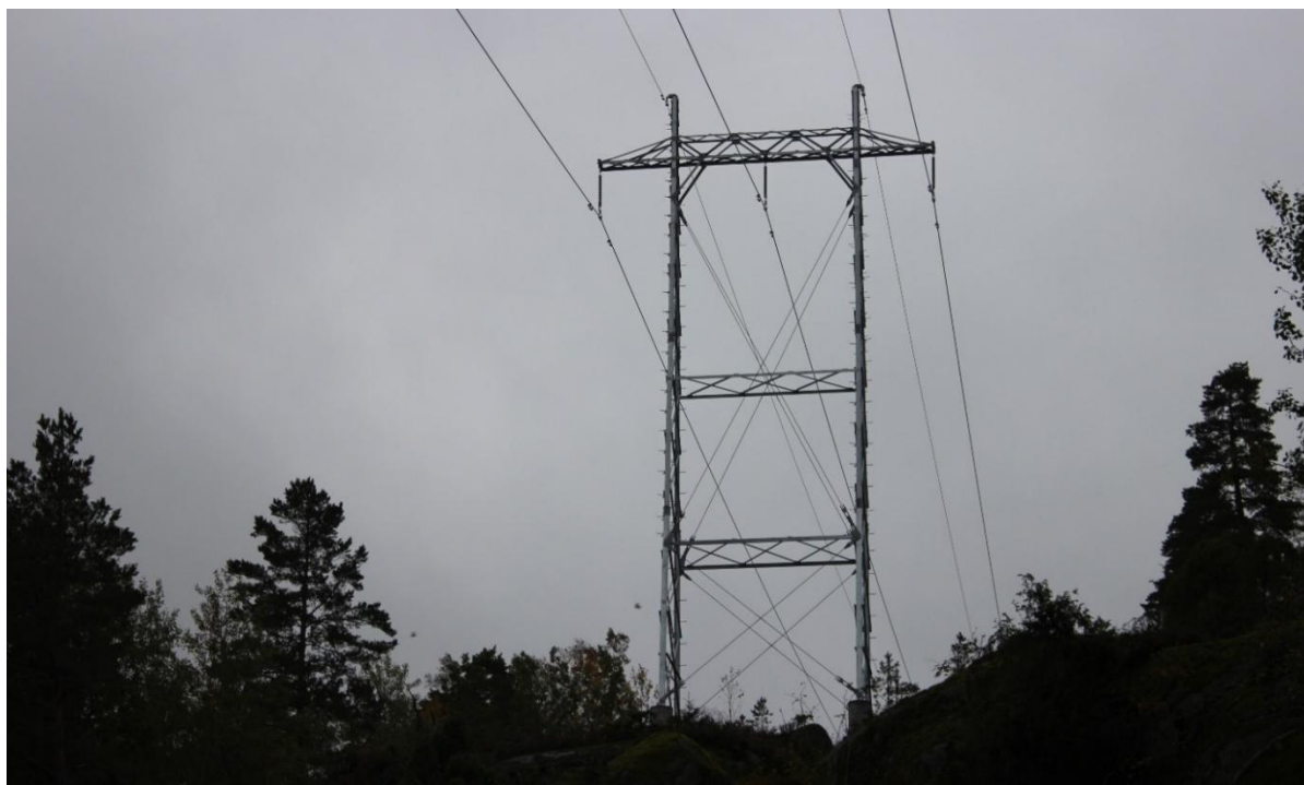
Figur 1-12. Bilde av 132 kV portalmast i stål med liner i horisontaloppheng.
