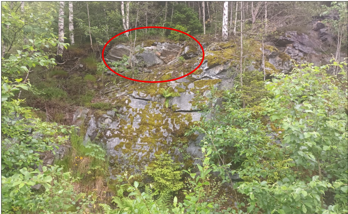
Figur 7: Utsprengt skjering i øvre del av bustadfeltet. I øvre del av skjeringa har fjellet foliasjonsplan med fall inn i berggrunnen, mot nord/nordaust (raud markering). Infopunkt 1.
