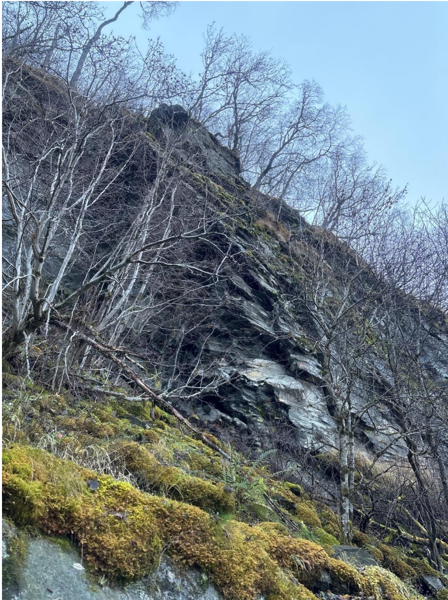
Figur 4: Skrent som viser høy grad av oppsprekking. Bildet ser mot sørvest og er tatt ca. 200 moh.
