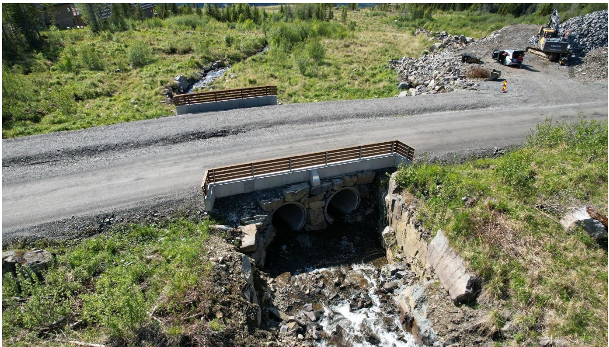
Figur 4: Dronebilde av der hovedløpet til Bjørgebekken krysser Storsteinvegen.
