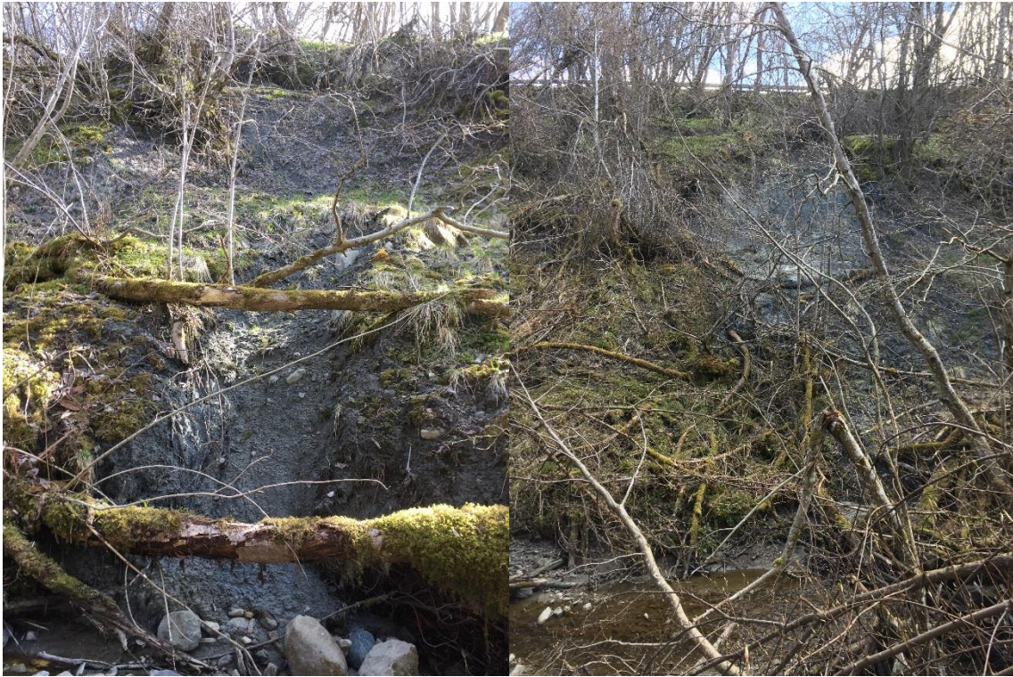
Bilde 236 og 242. Utglidninger litt lenger oppi skråningen ned mot elva, som kan true fylkesveien
