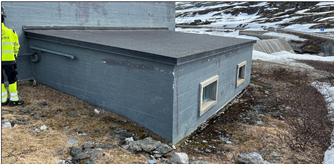
Figur 3-2: Dagens tilbygg som blir hevet for å få plass til nye komponenter.
