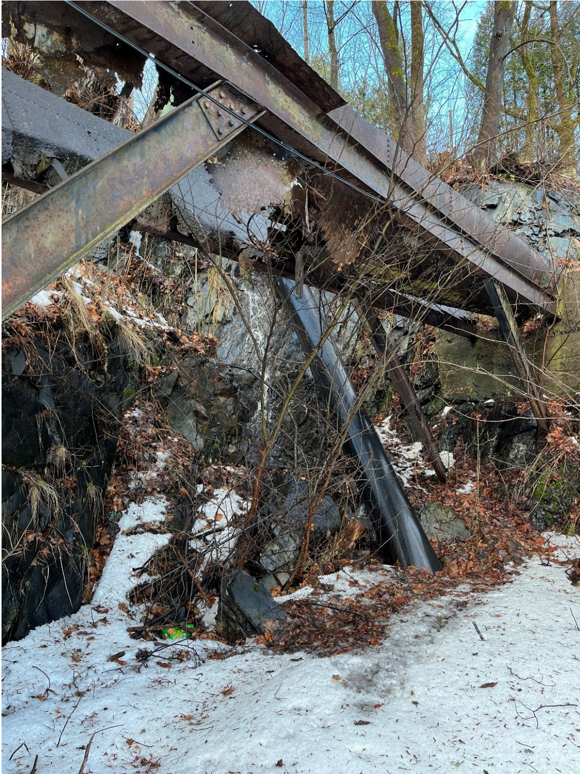
Figur 0-10 Bildet viser hvor dårlig forfatning eksisterende rørgate er i og at det kan være en fare for 3.person. Bildet viser også overvannsrøret som må tas hensyn til ved bygging av stasjonen og utløpet.
