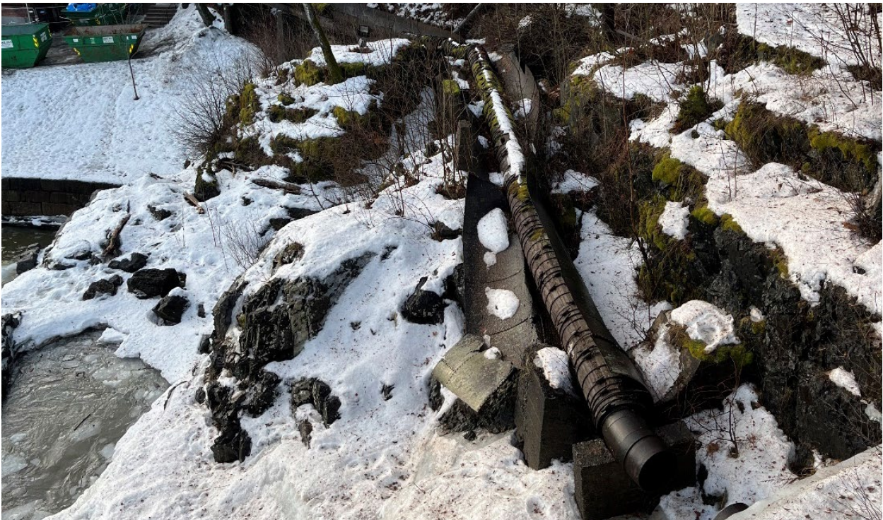
Figur 0-5 Her ses tre rør inni hverandre der både det største røret i metall ytterst og det midterste røret i tre er i ferd med å falle fra hverandre.
