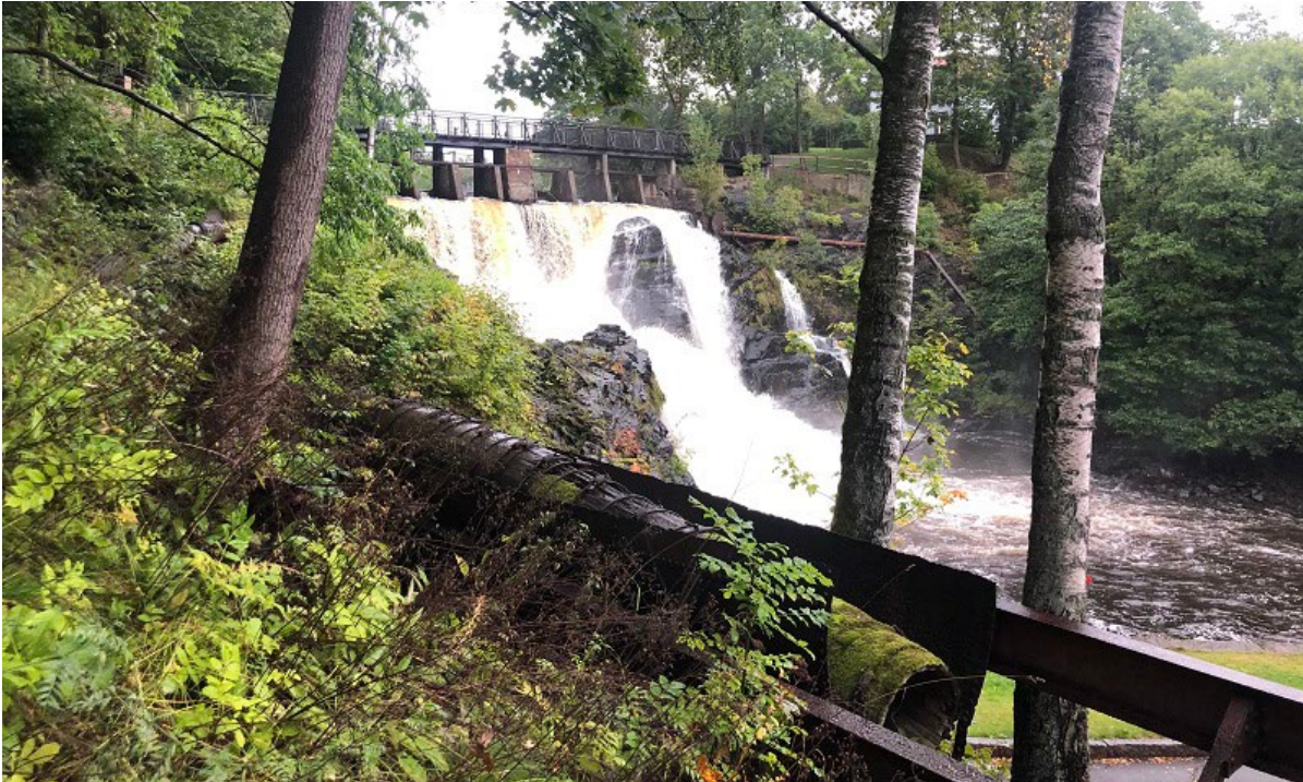
Figur 0-8 Eksisterende rør på begge sider av elva anbefales fjernet. Rørene er ikke i bruk og tilstanden er dårlig. Røret på den andre siden av elva er et forstyrrende element i landskapsbildet rundt fossen. Traseen til røret på denne siden av elva ligger bedre i terrenget og mindre eksponert til i landskapet.
