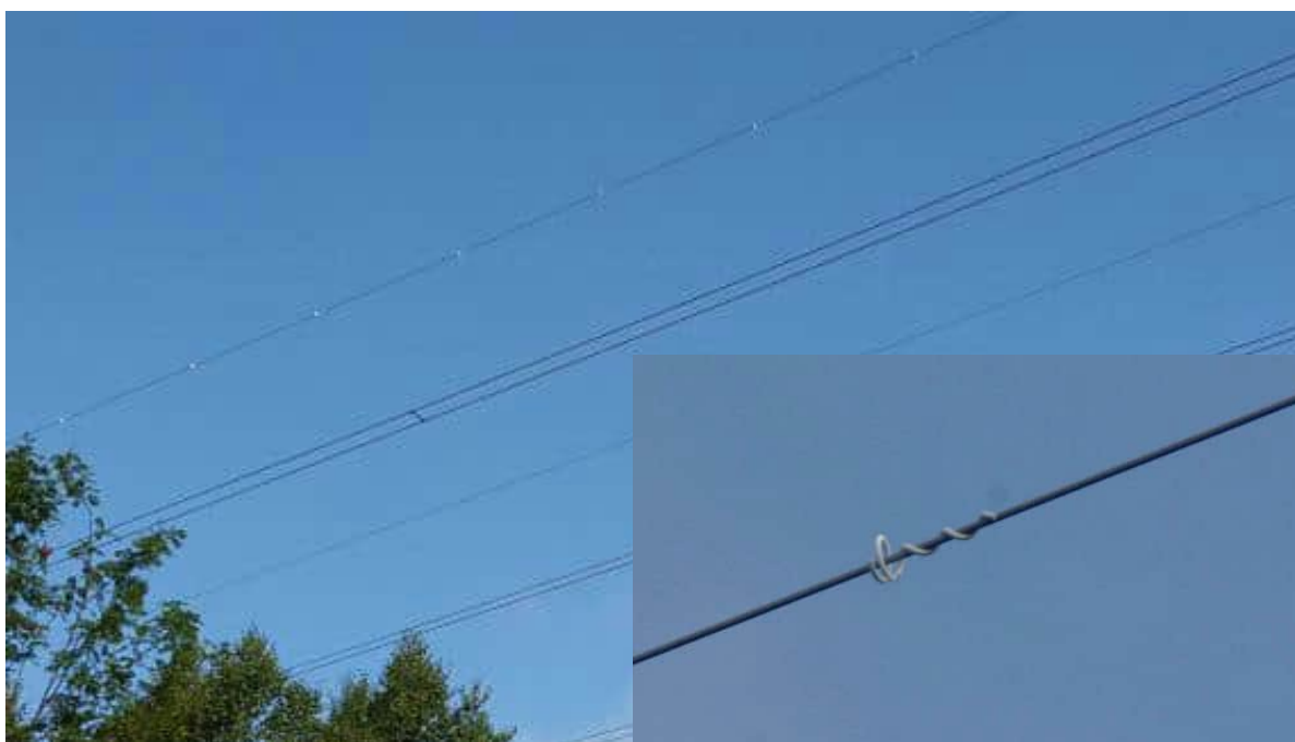
Figur 25 Bilde av ledning med fulgeavvisere (nærmest), samt detaljfoto av fugleavviser.
