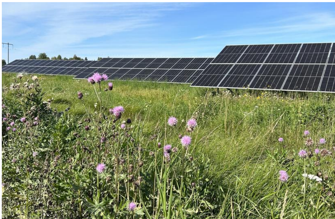
Figur 19 - Vegetasjon i solkraftverk sommeren etter bygging
