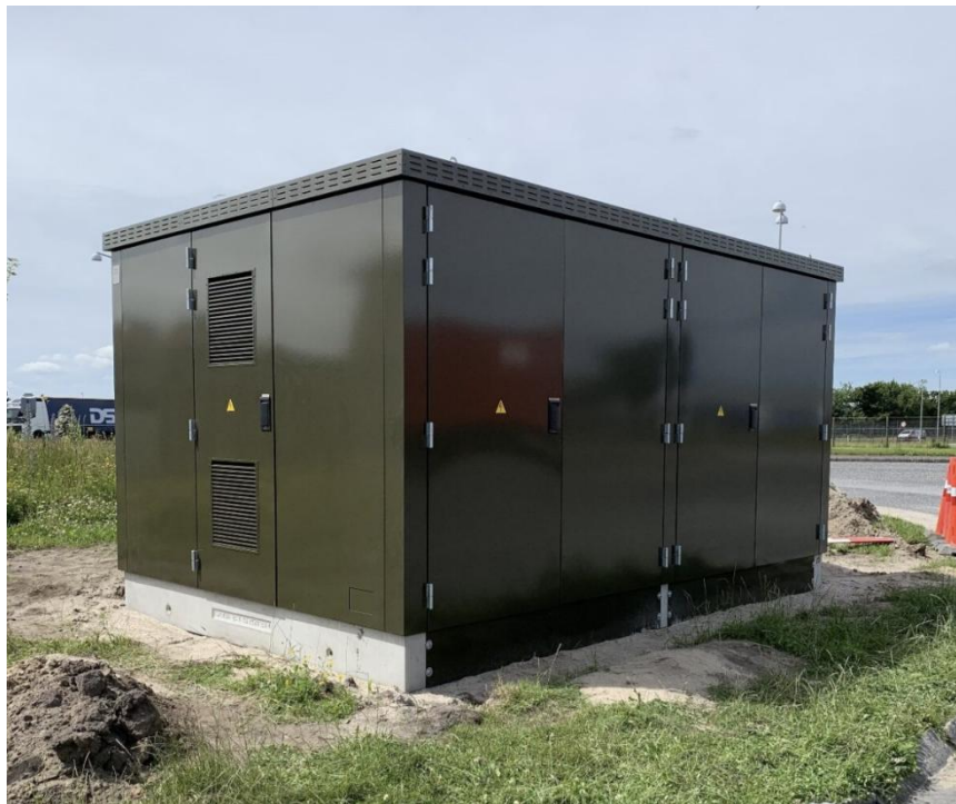
Figur 14: Illustrasjon på prefabrikkert nettstasjon.
