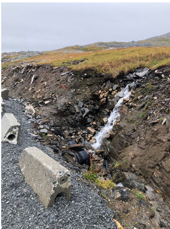
Figur 8: NVE så at flere av stikkrennene ikke fungerte etter hensikten. Enkelte var delvis fylt med stein, mens andre var lagt i feil høyde. Dette kan medføre økt fare for utvasking i flomsituasjoner. Stikkrenner som ikke fungerer etter hensikten bør utbedres. Foto: NVE.
