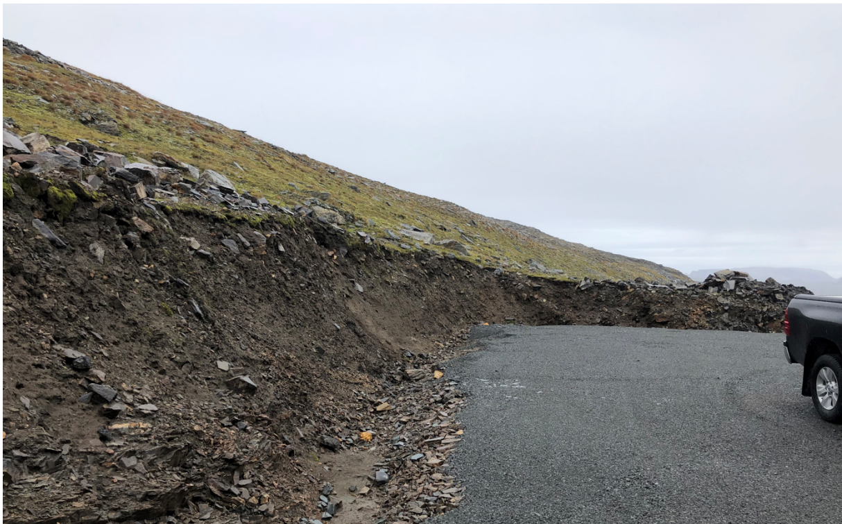
Figur 6: Eksempel på kranoppstillingsplass hvor toppen av skjæringen kan tilpasses bedre til eksisterende terreng. Se også kapittelet under om oppfølgingspunkter etter inspeksjonen i 2019. Foto: NVE.
