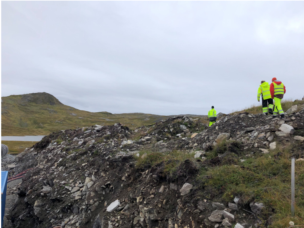
Figur 15: Området nordvest for transformatorstasjonen, hvor NVE mener det er behov for å rydde opp i massene og tilpasse bedre til sideliggende terreng. Foto: NVE.
