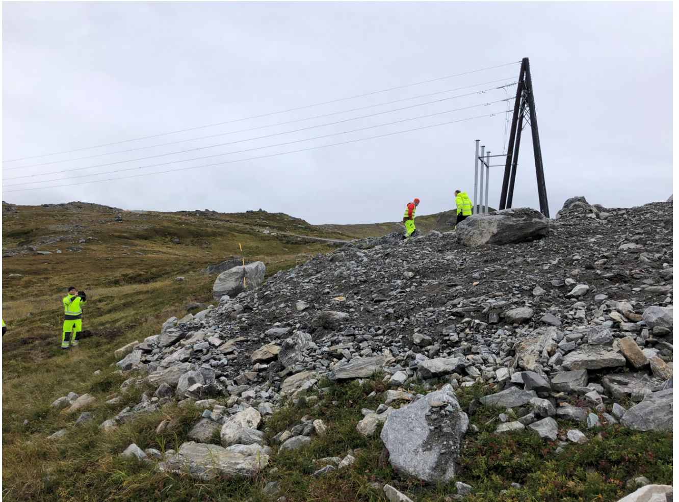
Figur 14: Massene som har glidd ut/blitt lagret på nedsiden av veien for transformatorstasjonen. Foto: NVE.
