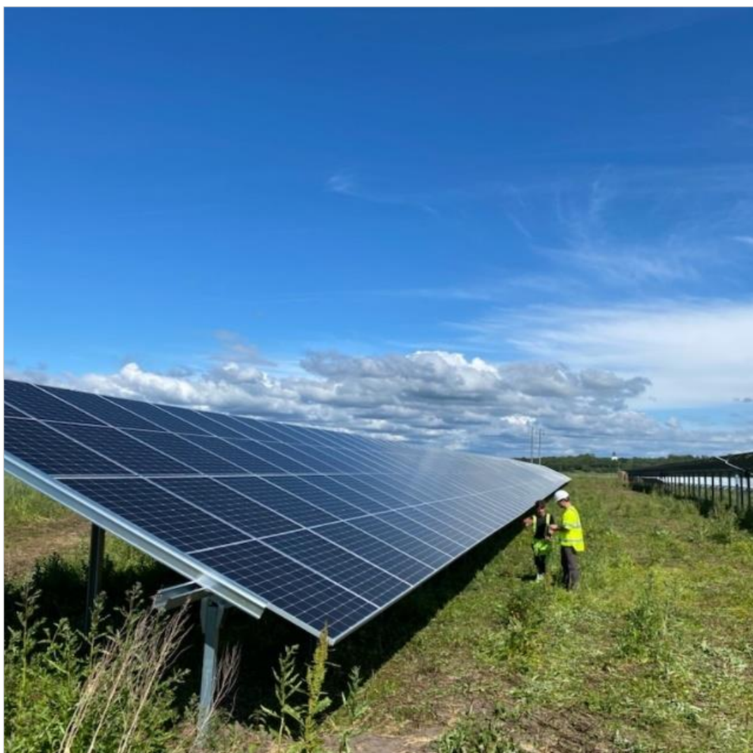
Figur 20: Bildet viser en solcellerekke fra Solgrids 4,8 MWp solkraftverk i Varberg, Sverige.
