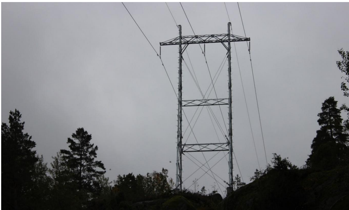
Figur 2-14. Bilde av 132 kV portalmast i stål med liner i horisontaloppheng.
