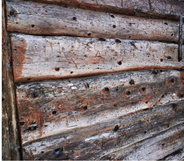
Figur 5-17: Skriblerier på ytre vegger på stølsbygning.
