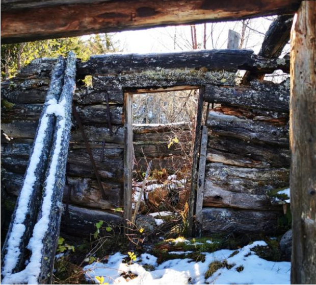
Figur 5-16: Bygning ved Lislestaul står til nedfalls.
