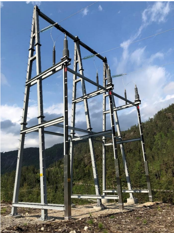
Figur 2-17. Bildet viser en kabelendemast. En slik kabelendemast er planlagt ved Såheim og sør for Svineroivegen, der den ledningen Mår-(Såheim)-Vestfjorddalen går fra luftledning til jordkabel.
