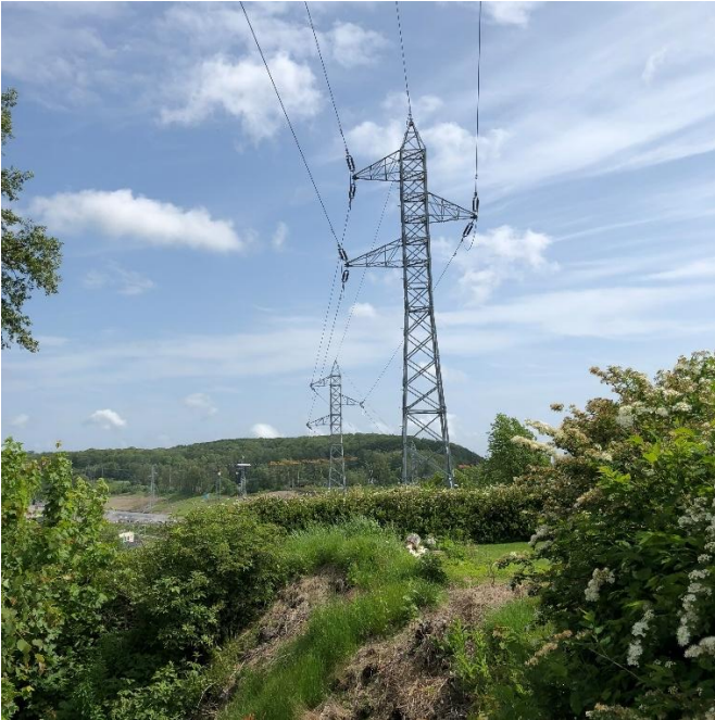
Figur 2-16. Bilde av tårnmast i stål med liner i vertikaloppheng.
