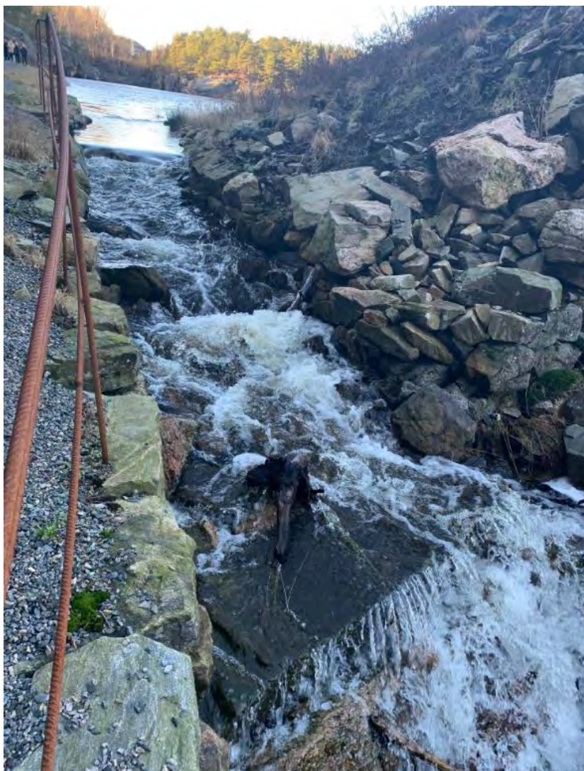
Figur 2-9: Utløpskanalen med ulike steinstørrelser som ligger løst på høyre side (mot dammen)
