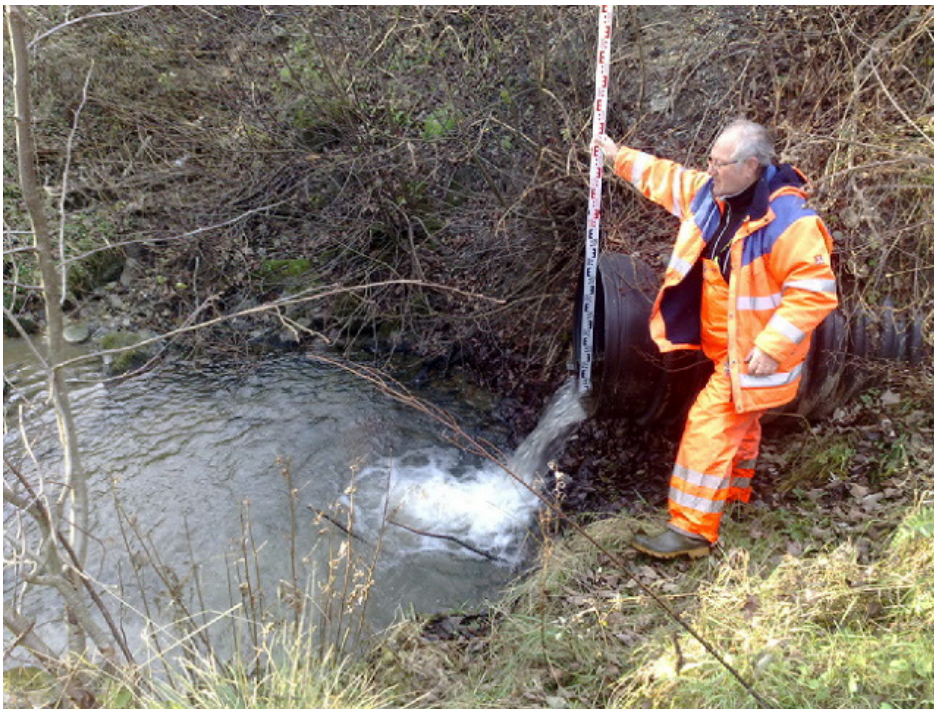
Bilde 4. Ved utløpet av kulvert som går under veien.
