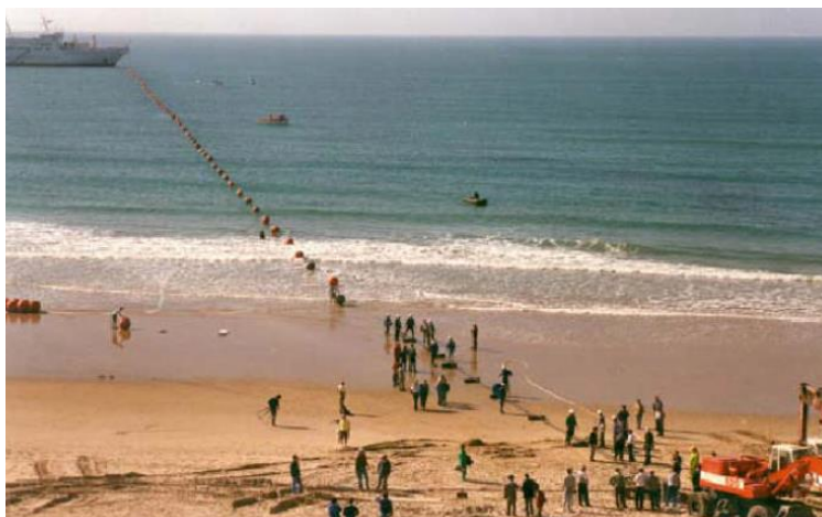
Figur 24 -Kabelinntrekk med flytere
