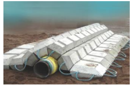
Figur 12 Beskyttelsesrør, kabel med betongmadrass
