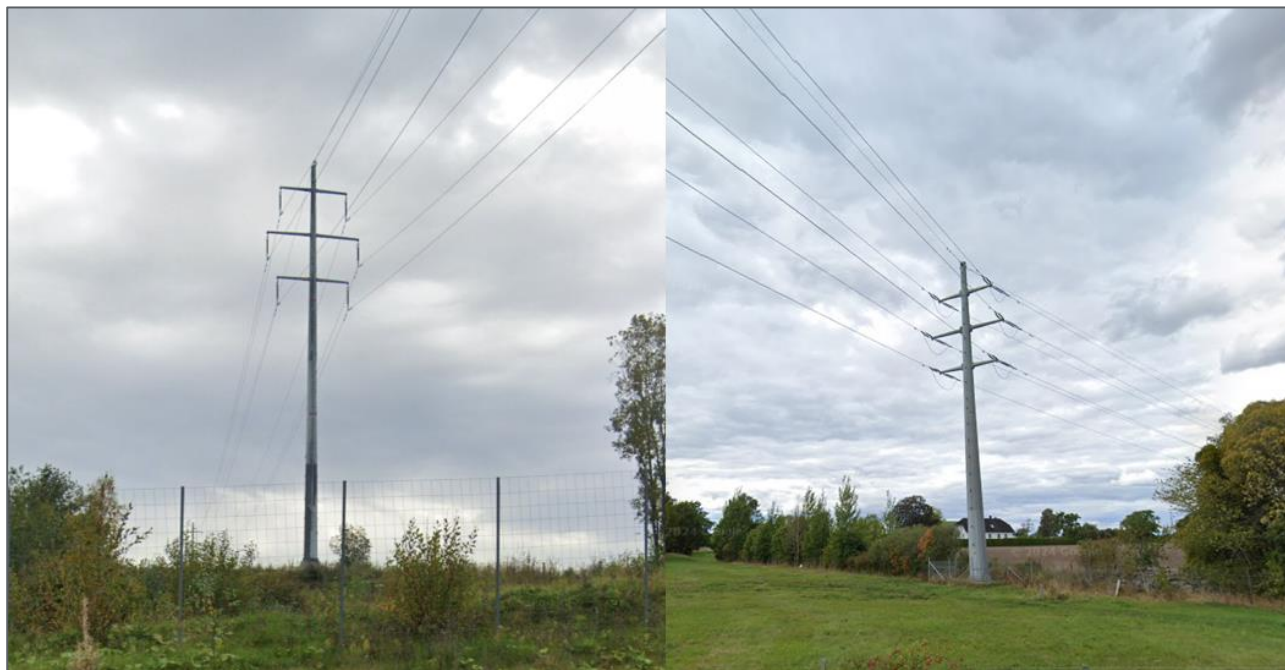
Figur 4-5: Eksempel på dobbeltkursmast med vertikalopphegt (høyre bilde viser vinkelmast). Hentet fra google streetview (Spydeberg-Tunby til venstre og Halmstad-Råde til høyre).
