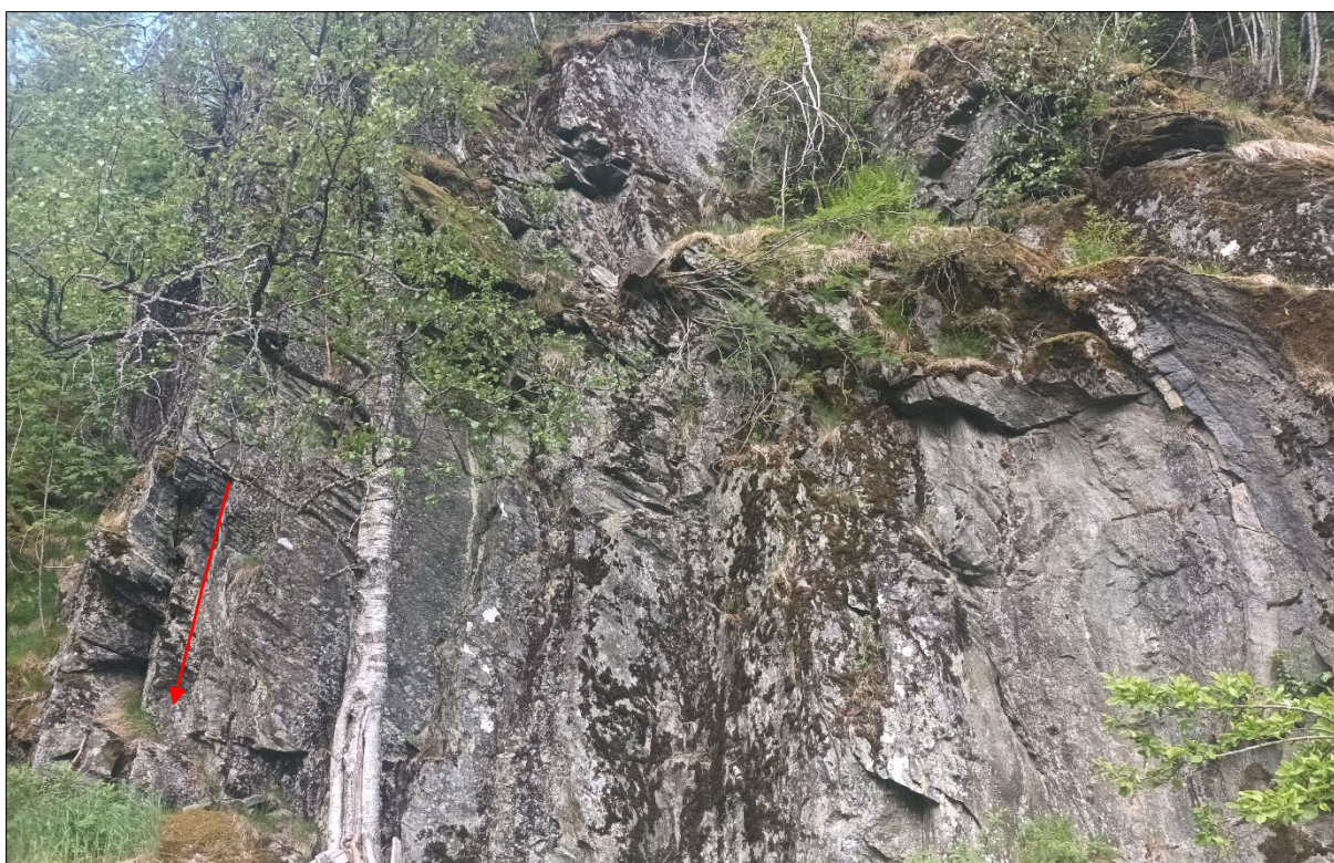
Figur 11: Biletet viser nedre del av hammarpartiet ovanfor austleg del av kartlagt område (infopunkt 10). Sprekkdanninga i berggrunnen endrar seg i nedre del frå kaotisk sprekkesett til å ha eit tydeleg hovudsprekkeplan som føl fjelloverflata (markert med raud pil). Sprekkdanninga er òg vesentleg høgare i nedre del av hammarpartiet.
