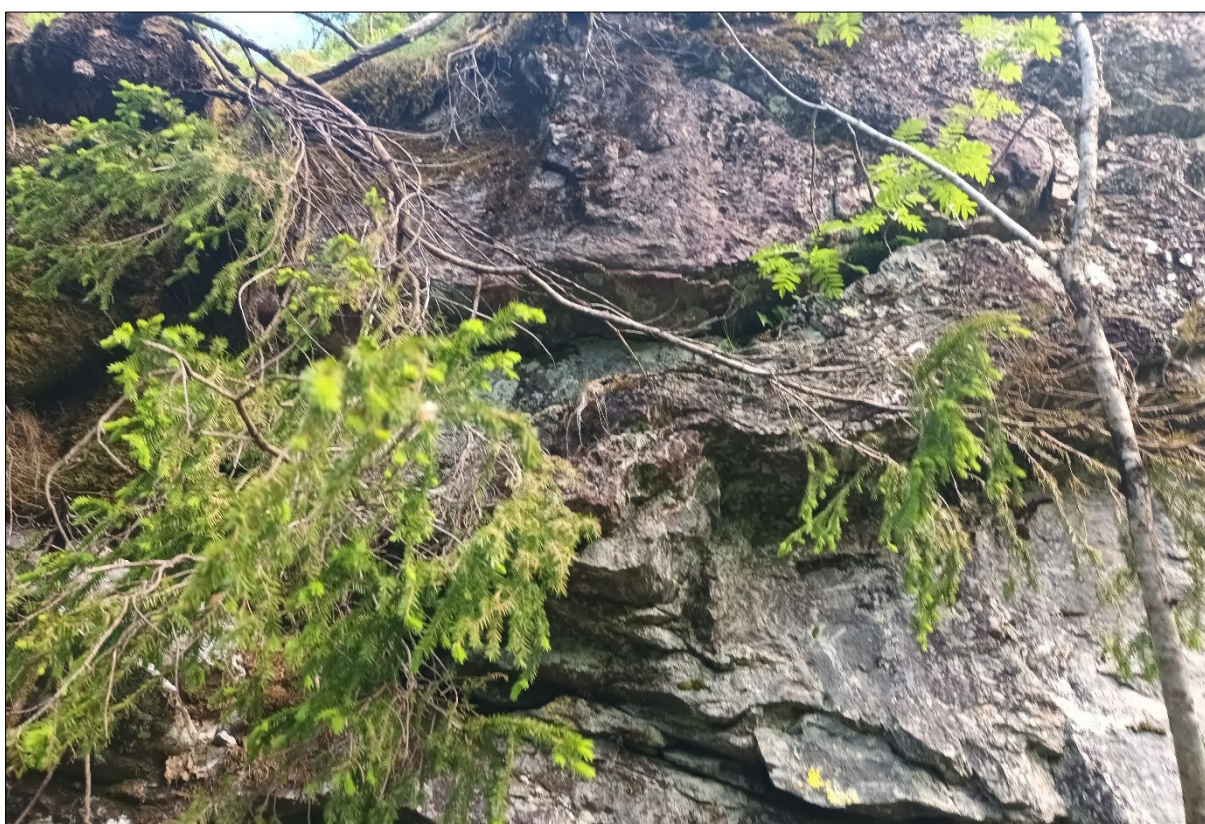
Figur 30: Det vart observert sprekkdanning langs hammarpartiet øvst i kløfta (infopunkt 6). Sprekkeplana har tilfeldig retning grunna mineralsamansettinga og kløvet i bergarten. Dette har hovudsakleg ført til mindre utrasingar av avlange blokker og flak (Figur 14).
